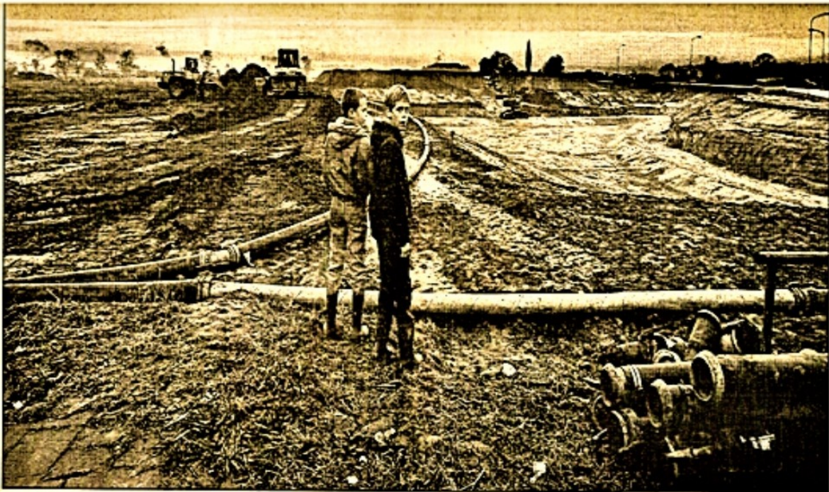
• Werkzaamheden aan de Bingerdensedweg. Meteen nadat de Raad van State zijn fiat heeft gegeven aan voortzetting van de bouw van de nieuwe wijk Campstede in Doesburg, zet de gemeente het licht voor de aannemers op groen. (Foto Jan van den Brink)
